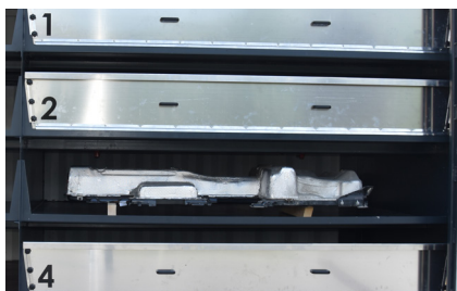
4 compartimentos inundables para baterías dañadas
