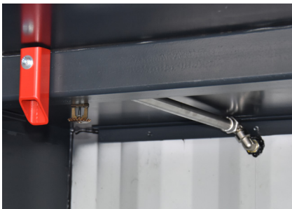
Sistema de rociadores
