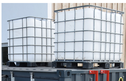
Tanques de 1000 lt montados en el techo para inundaciones
