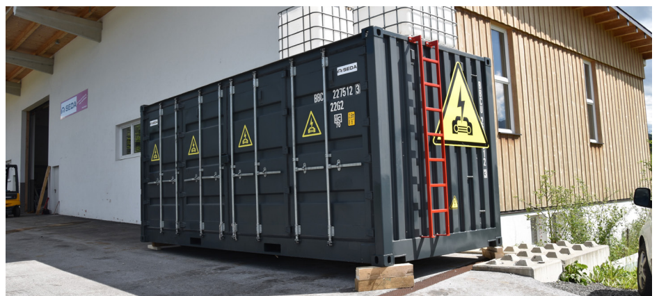
Almacenamiento seguro de baterías en contenedor estacionario ...
